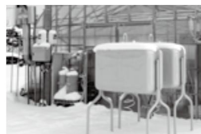
ハウスの外には暖房用のタンクが並ぶ。
